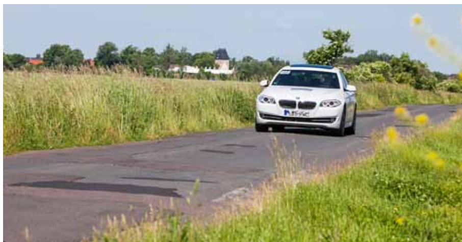
Sur les petites routes de campagne, il arrive que l'état de la chaussée n'aille pas sans risques.
